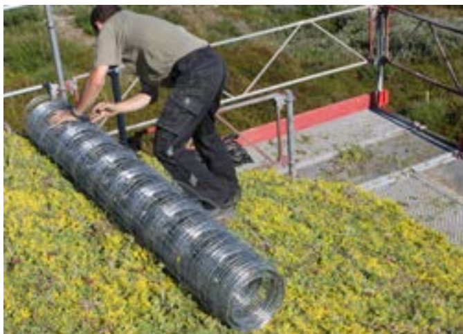
Figur 10.1 Grønt tag sikret med stålnet mod kraftig blæst.
