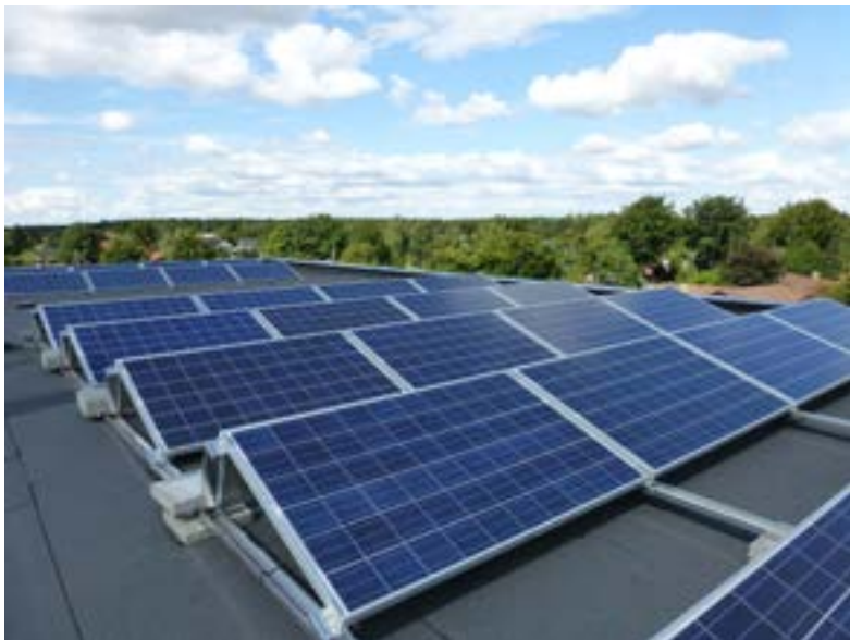
Figur 15.2.2.1: Eksempel på ballastsystem. Fastgørelse af ballastfliser mangler.
