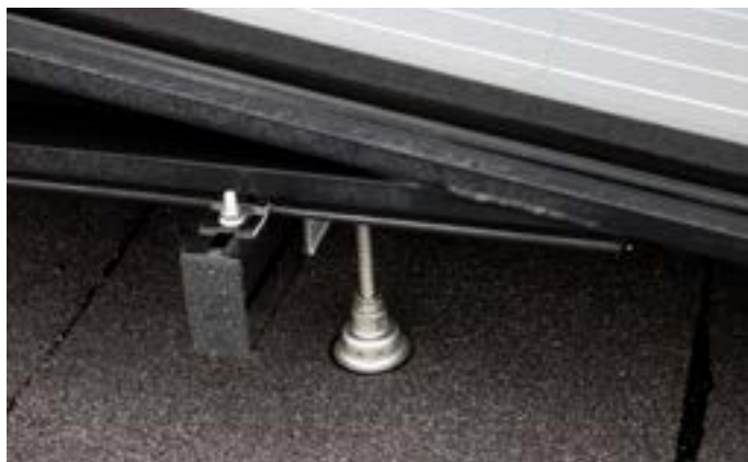
Figur 15.2.1.1.2: Eksempel på punktfastgørelse til solcelleanlæg.
