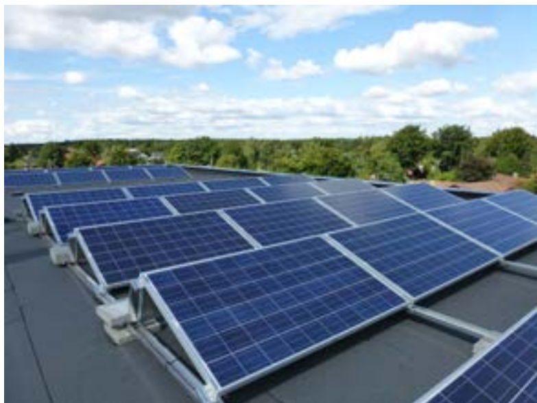
Figur 15.2.2.1 Eksempel på ballastsystem. Fastgørelse af ballastfliser mangler.
