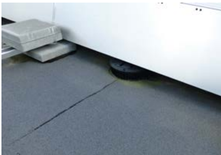
Figur 15.6.1 Afløb skal være tilgængelige, så de kan renses 1-2 gange årligt. Dette er særlig vigtigt ved UV-afløb. Der mangler fastgørelse af ballasten.
